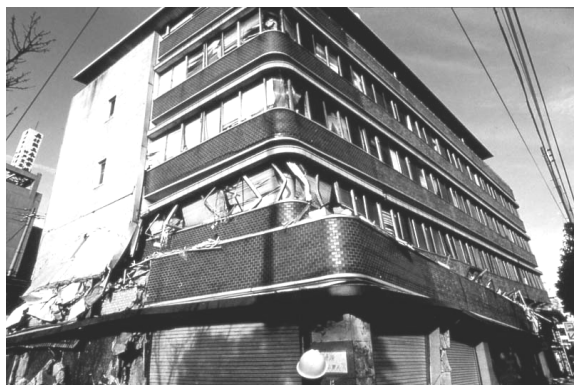
شکل ۶- تخریب یک ساختمان به‌علت نادیده گرفتن اثر سختی دیوار (کوبه ۱۹۹۵)
