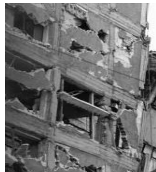
شکل ۵- ایجاد خرابی در ستون به علت اندرکنش با دیوار پرکننده (مکزیکوسیتی، ۱۹۸۵).
