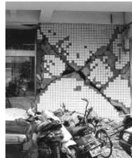
شکل ۳- ترک قطری دیوار پرکننده در زلزلهی تایوان (چی چی، ۱۹۹۹).
