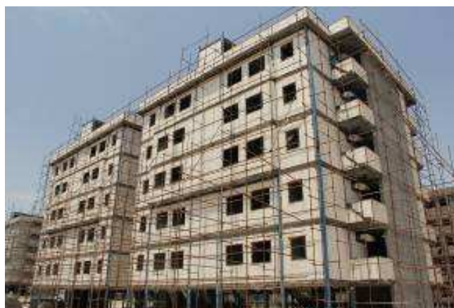
شکل ۲۱ ساختمان دارای پانل ایزی‌وال
