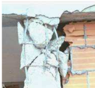
شکل ۴- شکست برشی ستون بتنی به علت تقابل با دیوار پرکنندهی آجری با بلوک سفالی غیرضخیم
