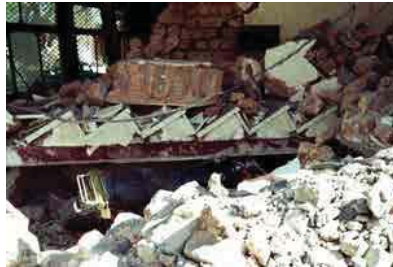
شکل ۶: نمونه‌ای از خرابی شمشیری فلزی پله در محل اتصال به پاگرد در زلزله ۱۳۸۲ بم (باخمن، ۱۳۸۹)
