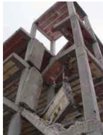
شکل ۷: نمونه‌ای از خرابی تیر شمشیری بتنی پله در محل اتصال به پاگرد علی‌رغم سالم ماندن سایر بخش‌های سازه، در زلزله ۱۳۸۲ بم (وانقی و همکاران، ۱۳۸۲)
