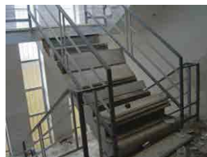
شکل ۱۴: شکست ساختار کف پله در ساختمان هلال احمر در زلزله ۱۳۸۲ بم (عشقی و همکاران، ۱۳۸۲)
