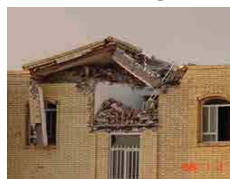
شکل ۱۷: نمونه ای از خرابی خرپشته در زلزله ۱۳۸۲ بم (باخمن، ۱۳۸۹)
