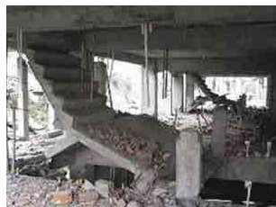
شکل ۱۳: نمونه ای از شکست ستون کوتاه در پاگرد راه پله سازه بتنی در زلزله ۲۰۰۸ ونچوان (Feng, et al, ۲۰۱۳)
