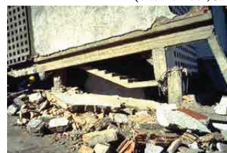
شکل ۱۲: نمونه ای از شکست ستون کوتاه در پاگرد راه پله سازه بتنی ساختمان کلینیک پزشکی در زلزله ۱۹۸۰ الاصلام (باخمن، ۱۳۸۹)
