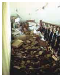
شکل ۱۶: شکست نازک کاری و عناصر غیرسازه‌ای در راه پله در زلزله ۱۹۷۲ ماناگوا، نیکاراگوئه (بسطامی و همکاران، ۱۳۹۰)
