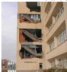
شکل ۱۵: خسارت وارده به دیوار اطراف راه پله در زلزله ۲۰۱۱ وان ترکیه (Alaluf, et al, ۲۰۱۲)
