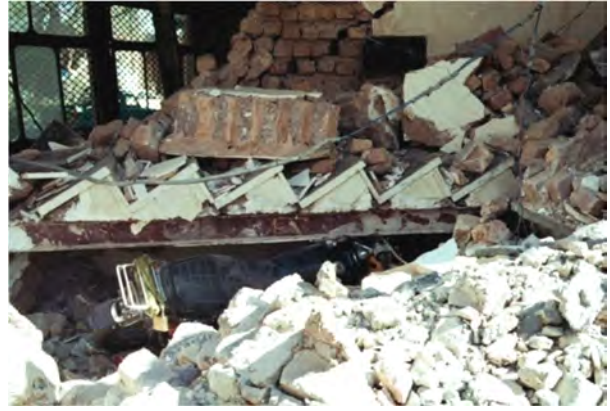
شکل (۶): نمونه‌ای از خرابی شمشیری فلزی پله در محل اتصال به پاگرد در زلزله ۱۳۸۲ بم [۵].
