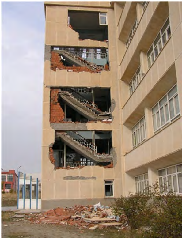
شکل (۱۹): خسارت وارده به دیوار اطراف راه‌پله در زلزله ۲۰۱۱ وان ترکیه [۲۵].
