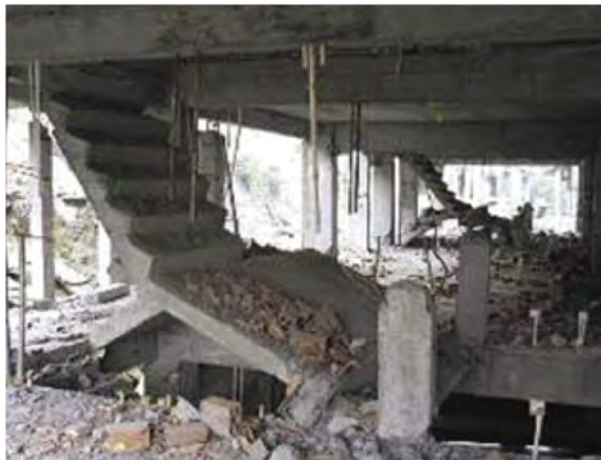
شکل (۱۴): نمونه‌ای از شکست در محل ستون‌های فرعی پاگرد در سازه‌ی بتنی در زلزله‌ی ۲۰۰۸ ونچوآن [۴].
