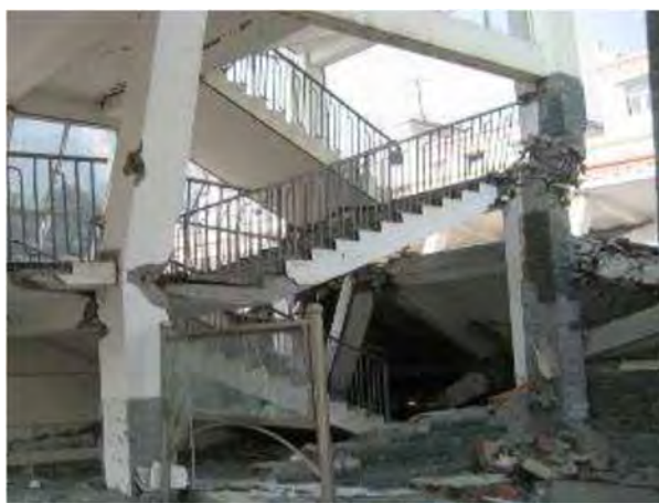
شکل (۱۲): نمونه‌ای از شکست ستون کوتاه در پاگردهای راه‌پله سازه بتنی [۱۲].
