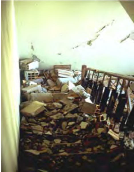
شکل (۲۲): شکست نازک کاری و عناصر غیر سازه‌ای در راه پله در زلزله‌ی ۱۹۷۲ ماناگوا، نیکاراگوئه [۷].
