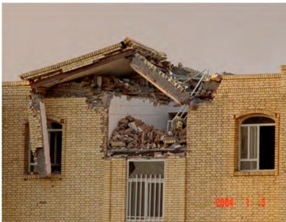
شکل (۲۳): نمونه‌ای از خرابی خرپشته در زلزله ۱۳۸۲ بم [۵].
