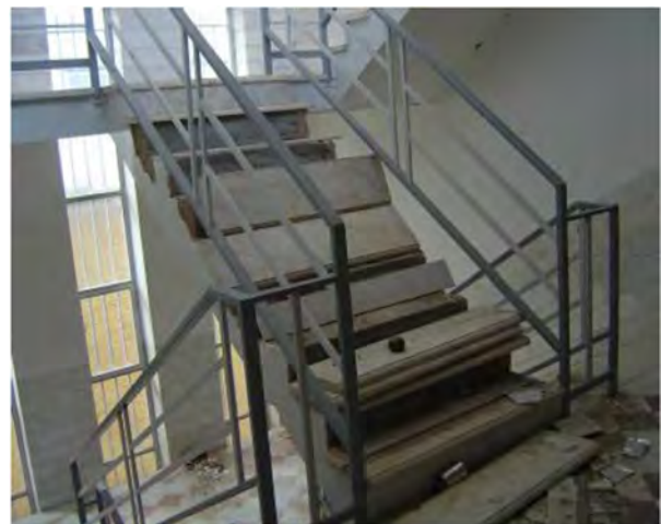
شکل (۱۸): شکست ساختار کف پله در ساختمان هلال احمر در زلزله‌ی ۱۳۸۲ بم [۲۴].
