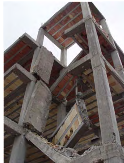
شکل (۷): نمونه‌ای از خرابی تیر شمشیری بتنی پله در محل اتصال به پاگرد علی‌رغم سالم ماندن سایر بخش‌های سازه، در زلزله ۱۳۸۲ بم [۲۰].
