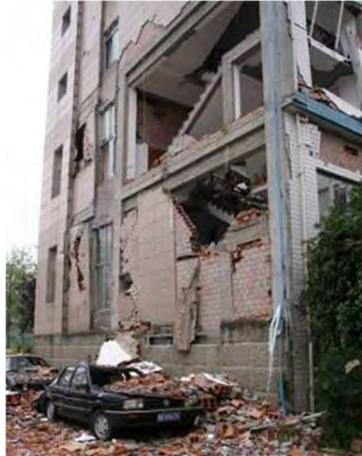
شکل (۲۰): خسارت وارده به دیوار اطراف راه پله در زلزله‌ی ۲۰۰۸ ونچوان چین [۲۶].
