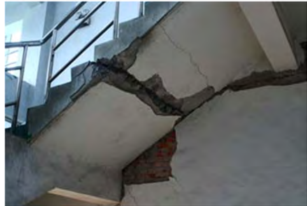
شکل (۲۱): شکست نازک کاری دیوارهای اطراف راه پله علاوه بر شکست دال پله در زلزله‌ی ۲۰۰۸ ونچوان چین [۱۹].
