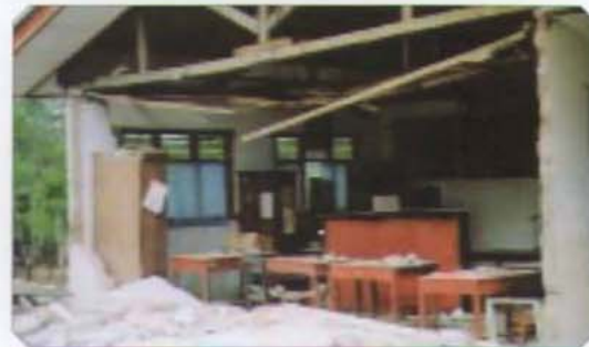
شکل ۲۱- ریزش کامل دیوار در شکست خارج از صفحه (اندونزی)
