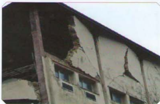
شکل ۱۹- شکست خارج از صفحه دیوار که در امتداد فوقانی آزاد است (سیلاخور)
