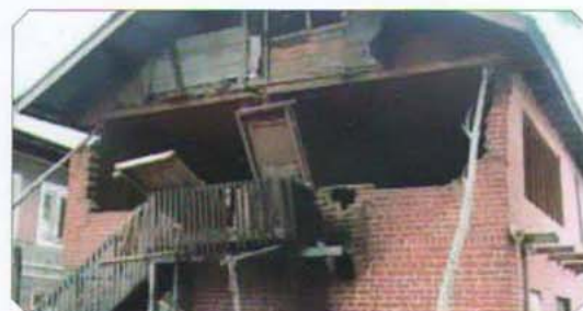
شکل ۲۳- شکست خارج از صفحه دیوار به علت اتصال نامناسب با سقف
