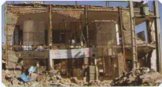
شکل ۴- شکست خارج از صفحه دیوار آجری در یک سازه فولادی مهم (بم ۱۳۸۲)
