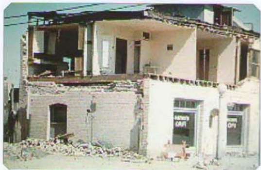
شکل ۱۶- شکست خارج از صفحه دیوار در طبقه دوم به علت اتصال نامناسب آن با سقف
