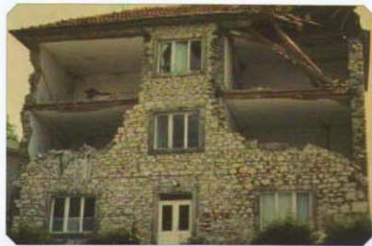
شکل ۷- شکست خارج از صفحه دیوارهای غیر باربر در یک ساختمان سنگی یا سقف چوبی (مونتنگرو، ۱۹۷۹)
