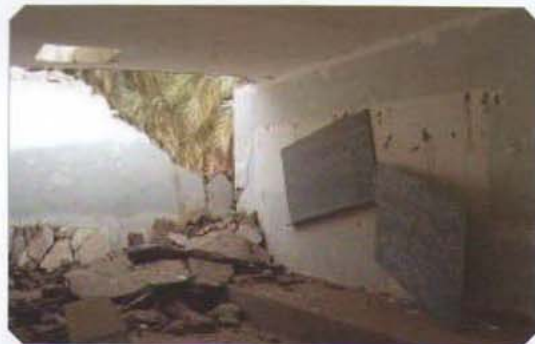
شکل ۸- شکست خارج از صفحه دیوار کلاس به علت انسجام نامناسب به سقف (یم ۱۳۸۲)
