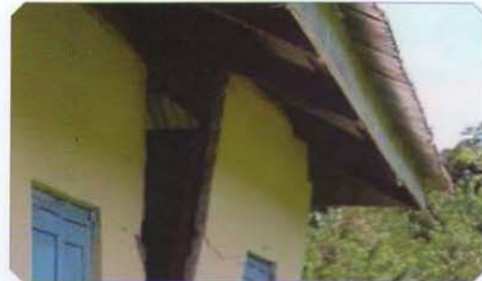
شکل ۲۰- شکست خارج از صفحه دیوار باربر و اتصال نامناسب آن به سقف خرابایی (هند)
