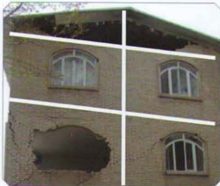
شکل ۲۴- شکست خارج از صفحه دیوار مثلثی و شکست پنجره به بیرون (بم ۱۳۸۲) (خطوط سفید، استرات‌های مورد نیاز را نشان می‌دهد که اجرا نشده است)
