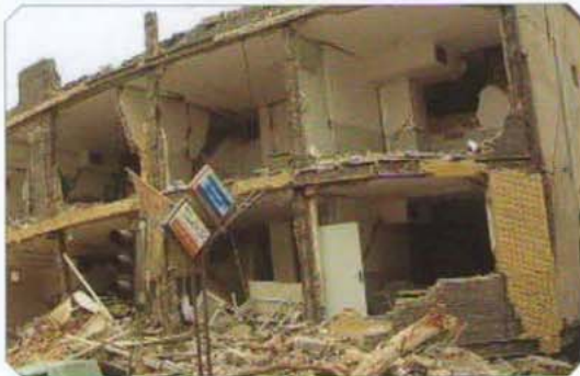
شکل ۶- شکست خارج از صفحه دیوارها و ریزش نما در یک ساختمان فولادی (بم ۱۳۸۲)
