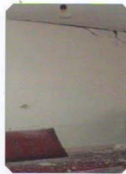
شکل ۹- جدایش دیوار از سقف و کناره ها به علت اتصال نامناسب (سیلاخور)
