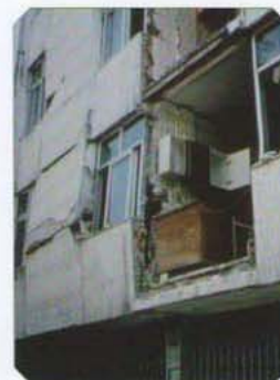
شکل ۳- شکست خارج از صفحه دیوار به‌صورت کلی و جزئی در ساختمان فولادی (منجیل ۱۳۶۹)
