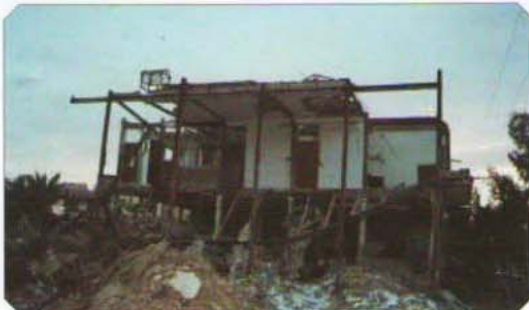
شکل ۵- شکست خارج از صفحه دیوار آجری در یک سازه فولادی (بم ۱۳۸۲)
