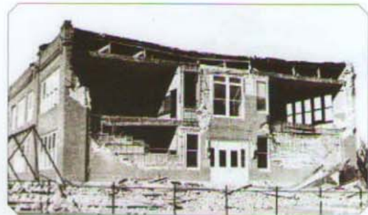
شکل ۱۳- شکست خارج از صفحه در دیوار یک مدرسه (کالیفرنیا، ۱۹۳۵)
