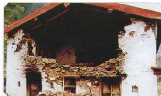
شکل ۲۲- نمونه‌ای از شکست خارج از صفحه دیوار در ساختمان بنایی دو طبقه شیروانی
