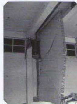
شکل ۲- فرو ریزش جزئی و شکست دیوار برگرنده آجری غیرمسلح در خمش خارج از صفحه (ساختمان تجاری در اندونزی، سوماترا ۱۹۸۷)
