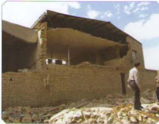
شکل ۱۷- شکست خارج از صفحه دیوار بنایی غیر مهندسی (سیلاخور)
