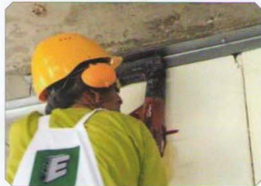
شکل ۲۶- روش اجرای نبشی ساخته شده از ورق برای ایجاد تکیه‌گاه در سقف
