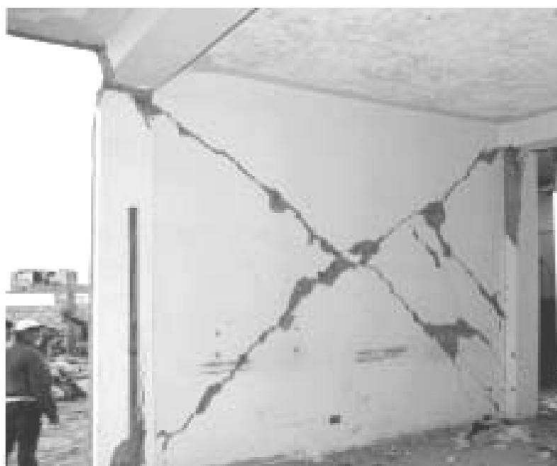
شکل ۶- ترک قطری دیوار پرکننده و آسیب قسمت فوقانی ستون
