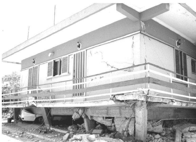
شکل ۱۶- شکست ستون کوتاه در طبقه‌ی زیرزمین
