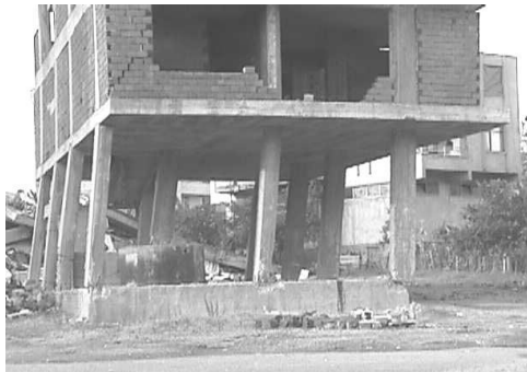
شکل ۷- تغییر شکل ناشی از طبقه‌ی نرم
