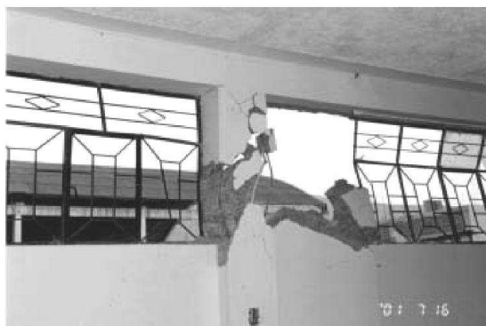
شکل ۱۵- شکست ستون کوتاه با وجود دیوار در یک طرف ستون کوتاه
