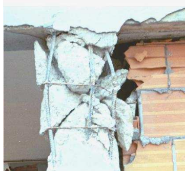
شکل ۲- شکست برشی ستون بتنی به علت تقابل با دیوار پرکننده ی آجری با بلوک سفالی غیرضخیم
