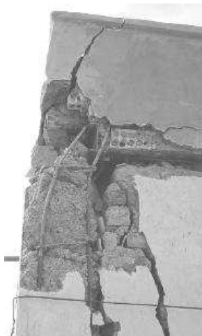
شکل ۵- شکست کلاف قائم بتنی به علت اندرکنش در دیوار
