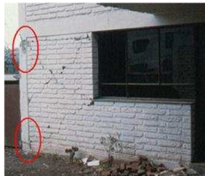
شکل ۴- شکست برشی کلاف قائم در دیوار آجری محصور شده
