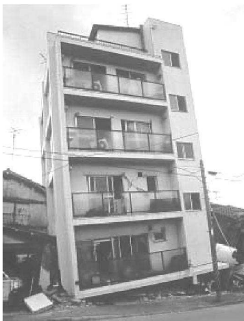
شکل ۸- قسمت بالای ساختمان که دارای مهاربند است، بر روی طبقه‌ی هم کف خوابیده است.
