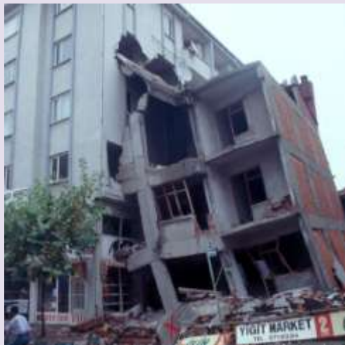
شکست خارج از صفحه دیوار پرکننده به علت ضربه دو ساختمان مجاور
