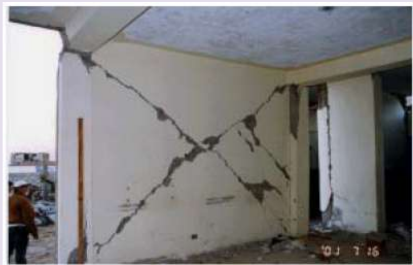
ترک قطری دیوار پرکننده و آسیب قسمت فوقانی ستون
