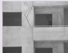
شکل ۱-۶۹- شکست برشی (قطری) ستون کوتاه
