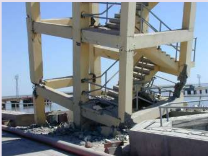
شکل ۹۳-۱- شکست ستون راه پله
