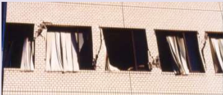
شکل ۱-۷۴- شکست برشی ستون کوتاه (دومین مود شکست متداول سازه‌های بتنی)
