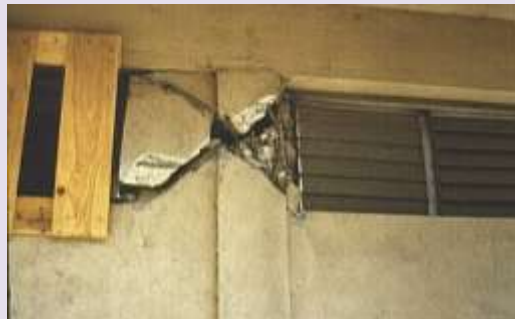
شکل ۱-۶۶- شکست ستون کوتاه
