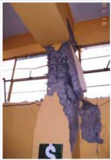
شکل ۱-۸۴- شکست ستون کوتاه در یک مدرسه
