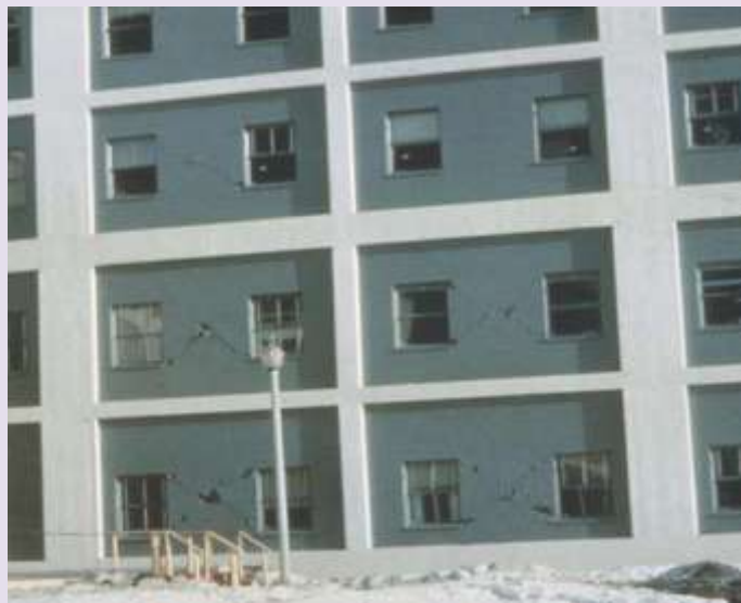
شکل ۱-۶۱- ایجاد ترک قطری در بین دو بازشو در دیوار آجری پرکننده
