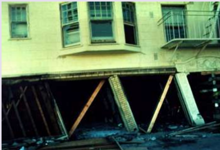
شکست خارج از صفحه دیوارها به علت نرمی طبقه
