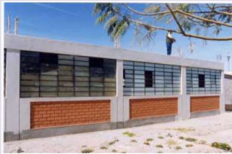
شکل ۱-۸۶- پتانسیل شکست ستون کوتاه در یک مدرسه
