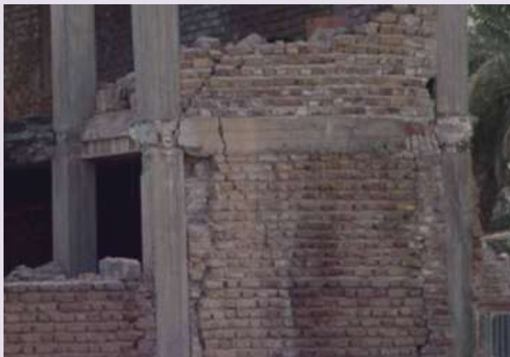
شکست برشی تیر بتن مسلح به علت اندرکنش با دیوار پرکننده آجری
