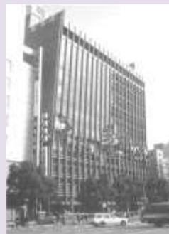
تخریب طبقه فوقانی به علت طبقه نرم
