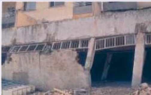
شکل ۱-۸۲- در این ستون اجرای جزئیات نامناسب مشاهده می شود (قلاب ۹۰ درجه بجای قلاب ۱۳۵ درجه) (Izmit, Turkey 1999).
