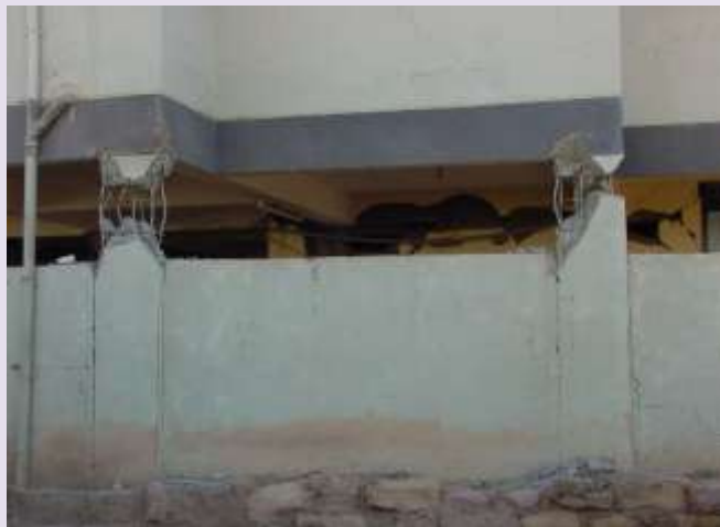
شکل ۱-۷۸- انهدام کامل ستون‌های کوتاه
