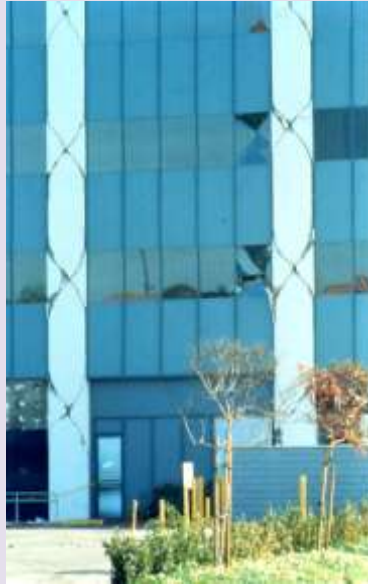
شکل ۱-۷۵- شکست ستون کوتاه (زلزله نورتریج، ۱۹۹۴)
