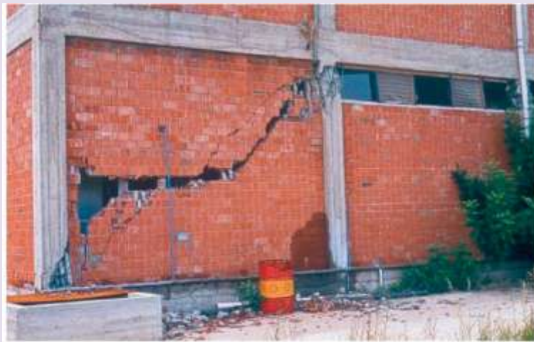
شکل ۱-۹۱- در مورد این ساختمان، دیوار آجری مقاومتر از ستونها بوده و باعث شکست برشی در ستونها گردیده است (Adana-Ceyhan, Turkey 1998). ترکیب شکست ستون کوتاه و شکست برشی ستون
