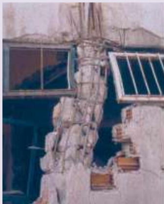
شکل ۸۰-۱- وجود باز شو طویل باعث ایجاد تنشهای شدیدی در ستون گردیده است.
