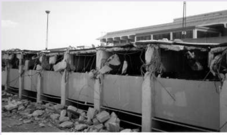
شکل ۱-۷۶- شکست ستون کوتاه
