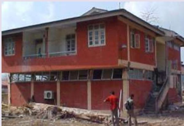
شکل ۱-۷۷- شکست ستون کوتاه
