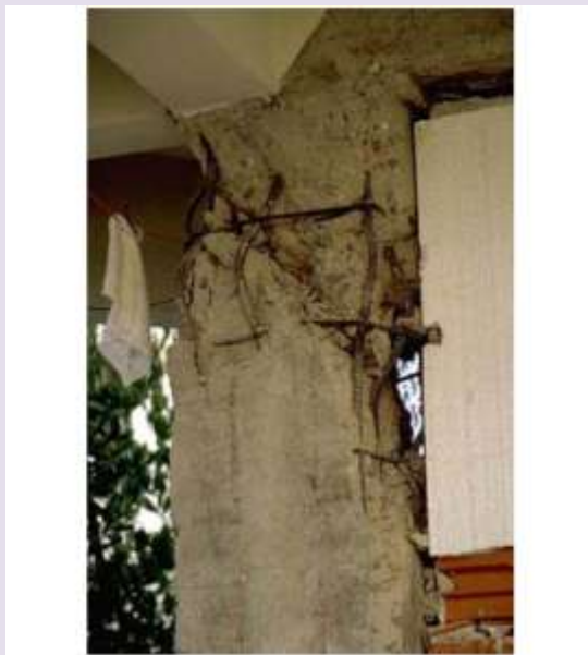
شکست برشی ستون بتنی به علت اندرکنش با دیوار پرکننده
