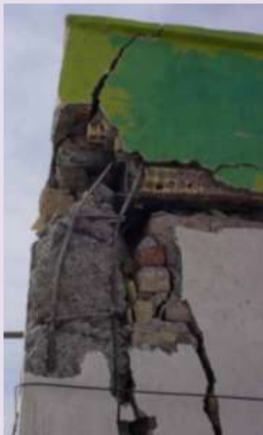
شکست کلاف قائم بتنی به علت اندرکنش در دیوار
