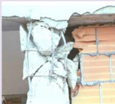
شکست برشی ستون بتنی به علت تقابل با دیوار پرکننده آجری با بلوک سفالی غیر ضخیم
