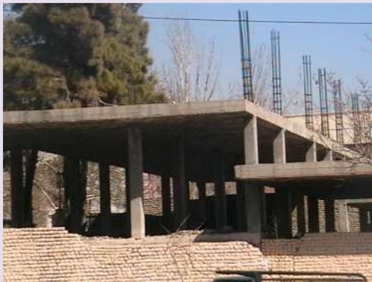
شکل ۱-۸۸- ستون کوتاه به علت هندسه معماری و وجود دیوارها
