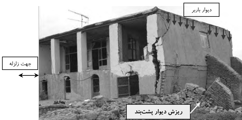
شکل ۳۴.۲ شکست خارج از صفحه‌ی دیوار مرتفع به علت عدم اتصال به سقف میانی (ادامه دارد).
